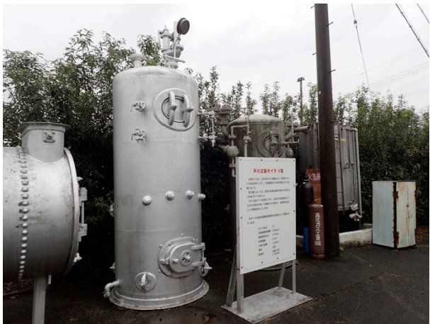
写真2 立型ボイラ(1952(昭和)27年製, 撮影:二階堂, 2023/11/10) 効率は低いが据付面積が小さい。
