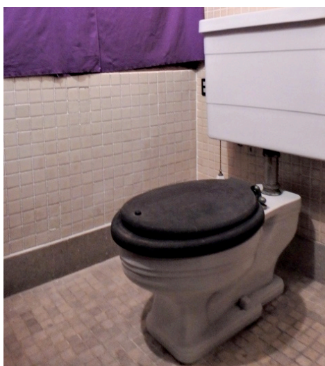
写真1 畝傍駅貴賓室の腰掛式大便器 (撮影：岡田広一)
