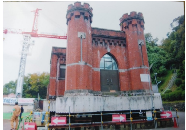
写真2 曳家工事中の蹴上浄水場第1 高区配水池・流入弁室（同池改良工事に伴って実施された） （京都市上下水道局が公式の動画を公開中。
